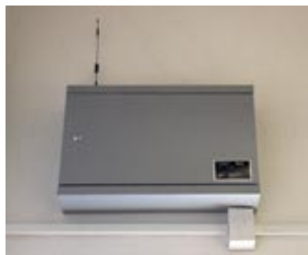
Ethernetové přepínače jsou ve skříních vysoko na stěnách výrobních hal
