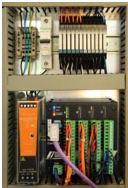
Malé rozvaděče s jednotkami DataLab jsou vždy v blízkosti ovládaných zařízení
